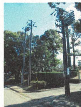
配電線 手前から引込柱、117802、117801
