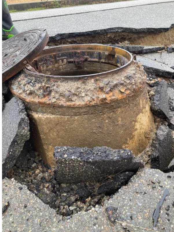
▲マンホールの隆起
