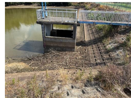
▲ 取水施設の劣化
