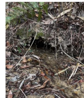
▲ 堤体からの漏水
