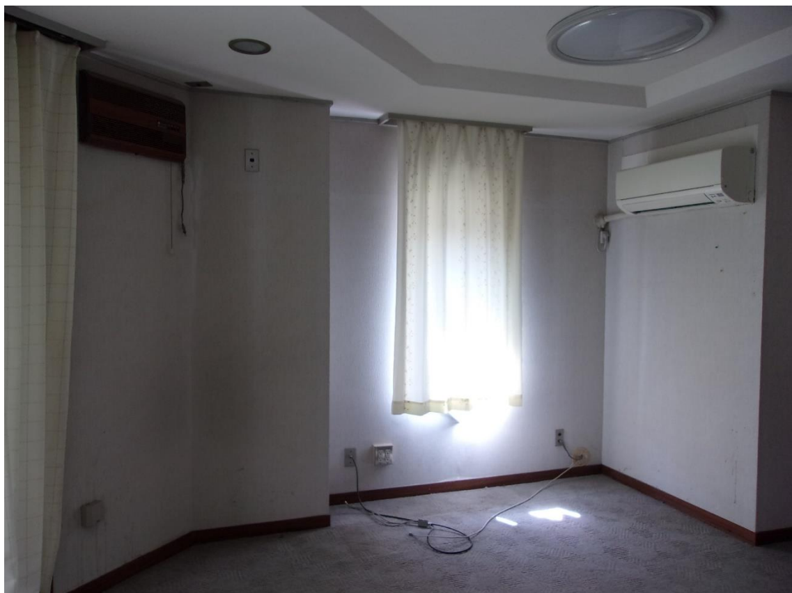
参考写真 残置されているエアコン
