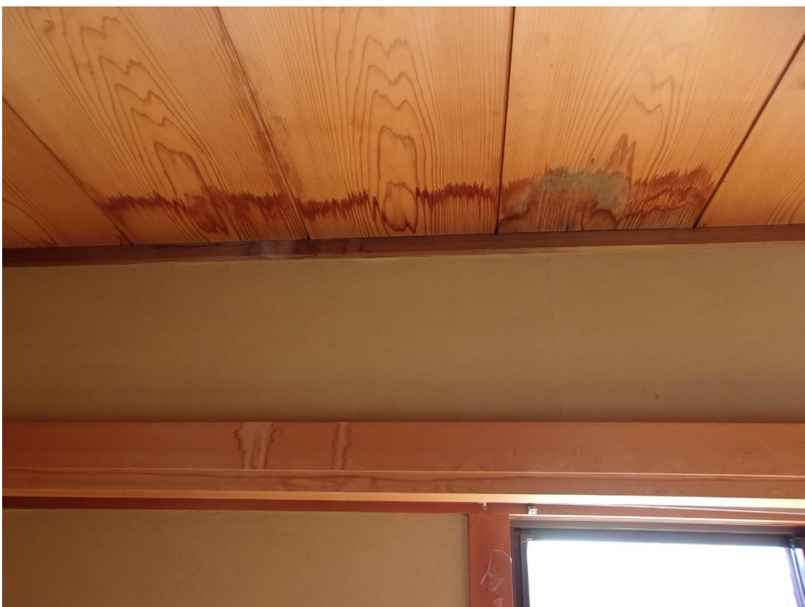
参考写真 1階和室（大）雨漏り
