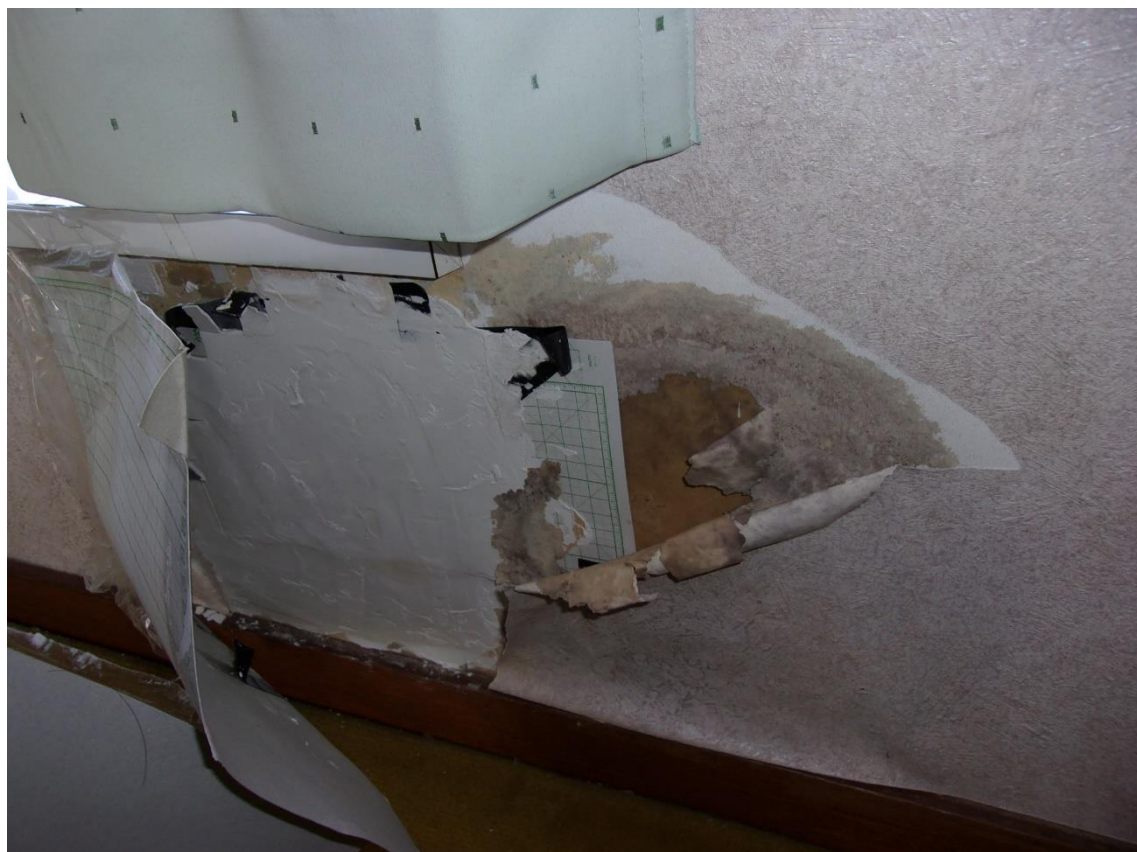
参考写真 2階洋室 出窓下 クロスの剥がれ
