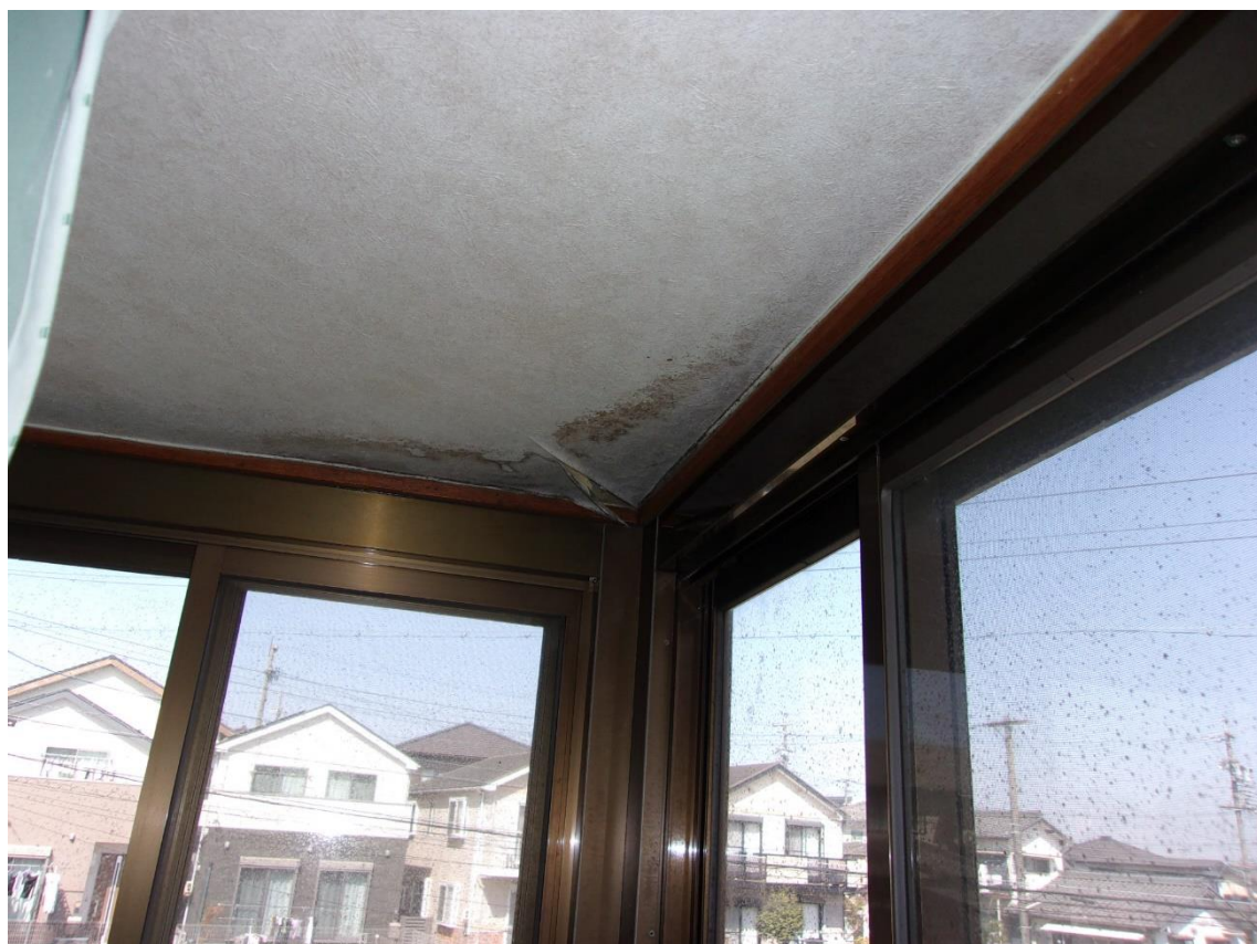
参考写真 2階洋室 出窓の結露による破損
