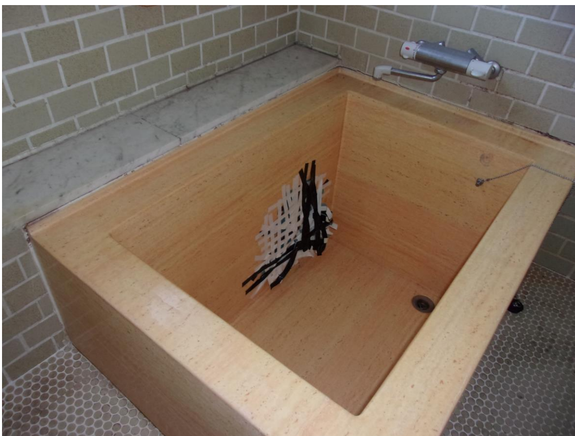
参考写真 風呂場 損傷
