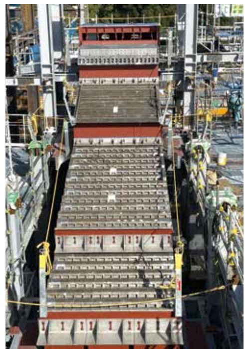
▲ストーカ設置状況
