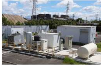
水素供給設備例
