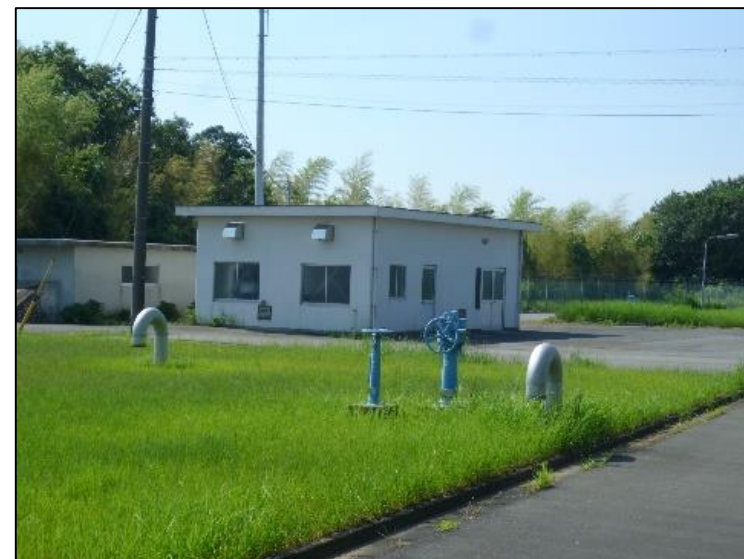
▲ 現在の丸根配水場の様子
