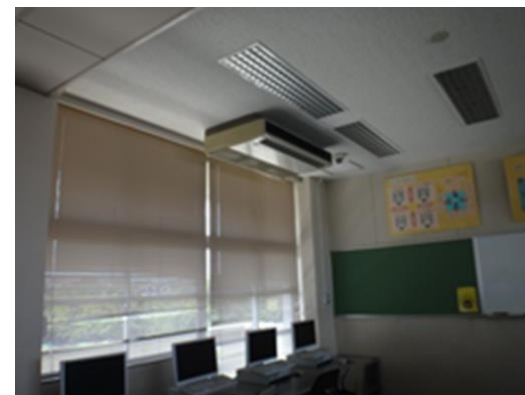
▲ エアコン設置済みの特別教室
