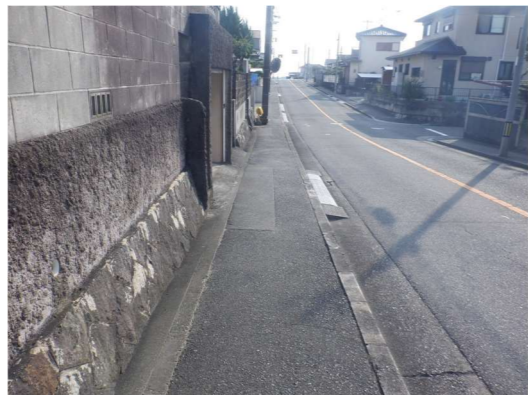
6 対応不可 歩道の修繕
