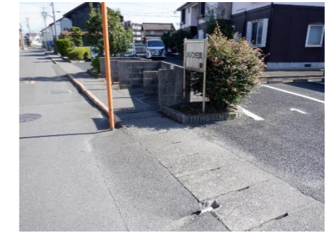
5 対応済 側溝修繕
