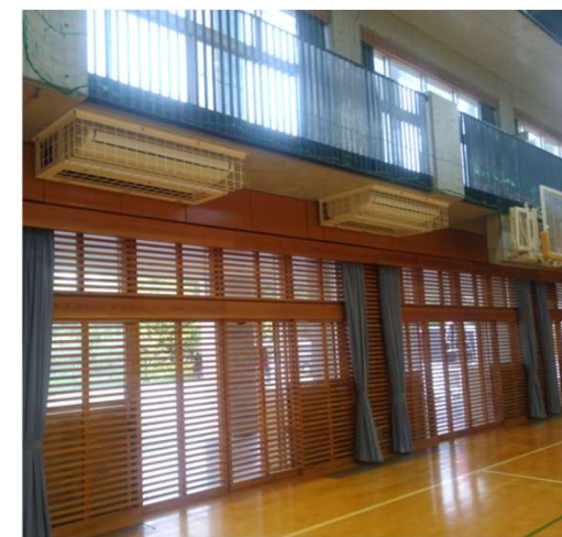
▲体育館空調設備
