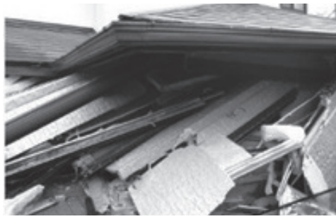
▲住宅倒壊の様子 出典：国土交通省HP
