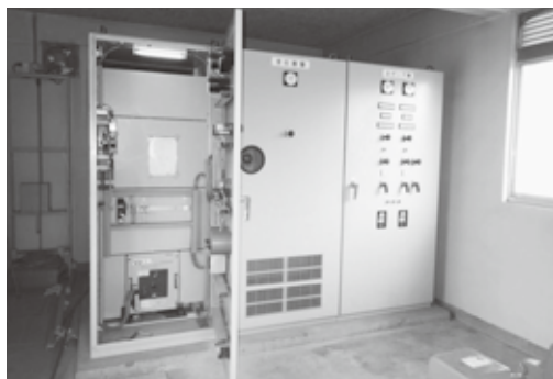
工事を行った揚水機場の操作盤・受電盤
