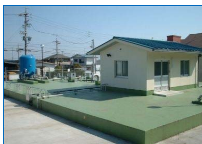
粕谷台ポンプ場
