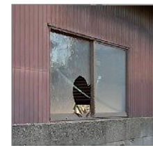
窓が割れた管理不全空家
