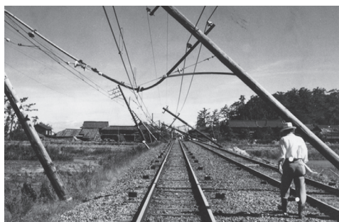
▲翌日の知多町長による被害状況視察の様子(日長川鉄橋南付近)
