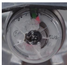
× 指示圧力計の損傷
