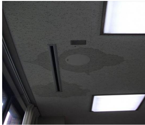
天井の雨漏り①
