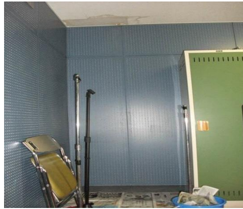
天井の雨漏り②
